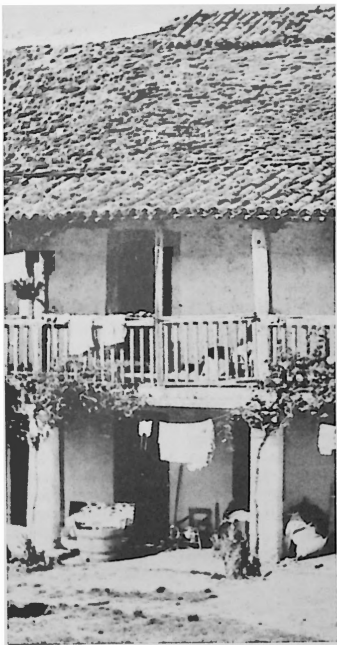
Esempio di tetto senza grondaie, da cui caderano le straségne.
